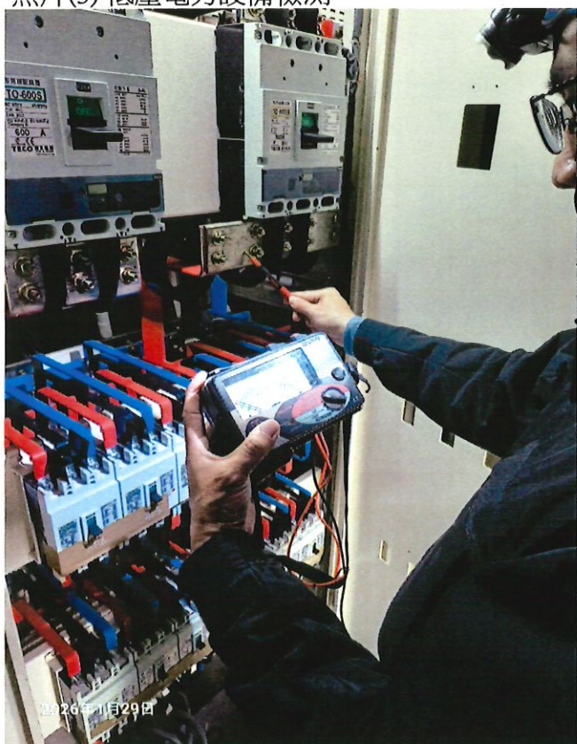
照片(3) 低壓電力設備檢測
