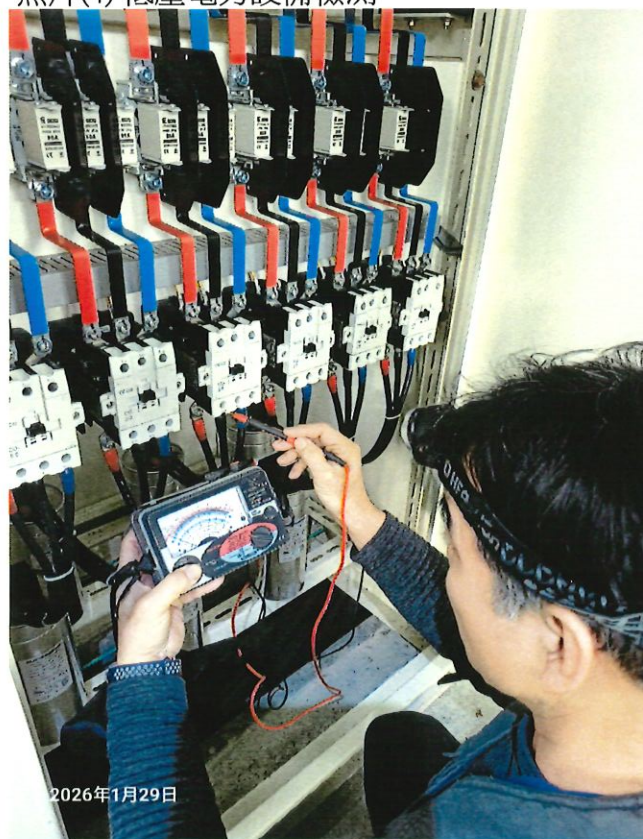
照片(4) 低壓電力設備檢測
